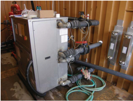
Φωτό 1: Γ/Θ αντλία θερμότητας νερού-νερού 100 KW πλήρως εγκατεστημένη εντός μεταλλικού container.
