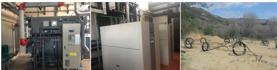
Εικόνα 4. Ψύκτης απορρόφησης (αριστερά), γεωθερμικές αντλίες θερμότητας (κέντρο), γεωεναλλάκτης (δεξιά)
