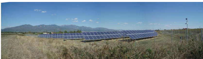
Εικόνα 1 : Φωτογραφία του φ/β σταθμού ονομαστικής ισχύος 97 kWp.
