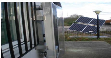
Εικόνα 3 Σύνδεση Ηλιακού Συλλέκτη-Οικίσκου
