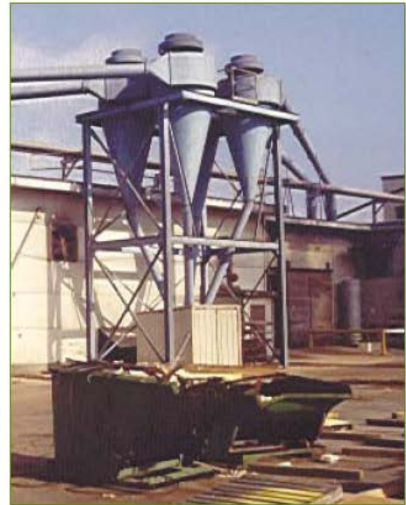
Κυκλώνες για απομάκρυνση της σκόνης
