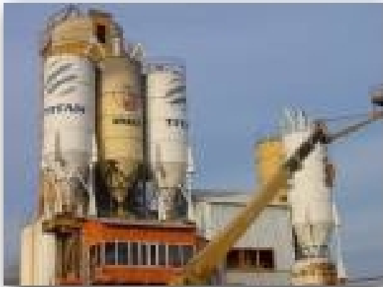
Αποκονίωση 5 σιλό τσιμέντου με 2 αυτοκαθαριζόμενα φίλτρα
