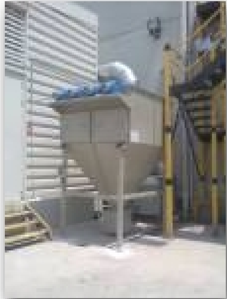
Αποκονίωση σε εργοστάσιο παραγωγής προϊόντων υγιεινής, με φίλτρο επιφάνειας 160 m 2
