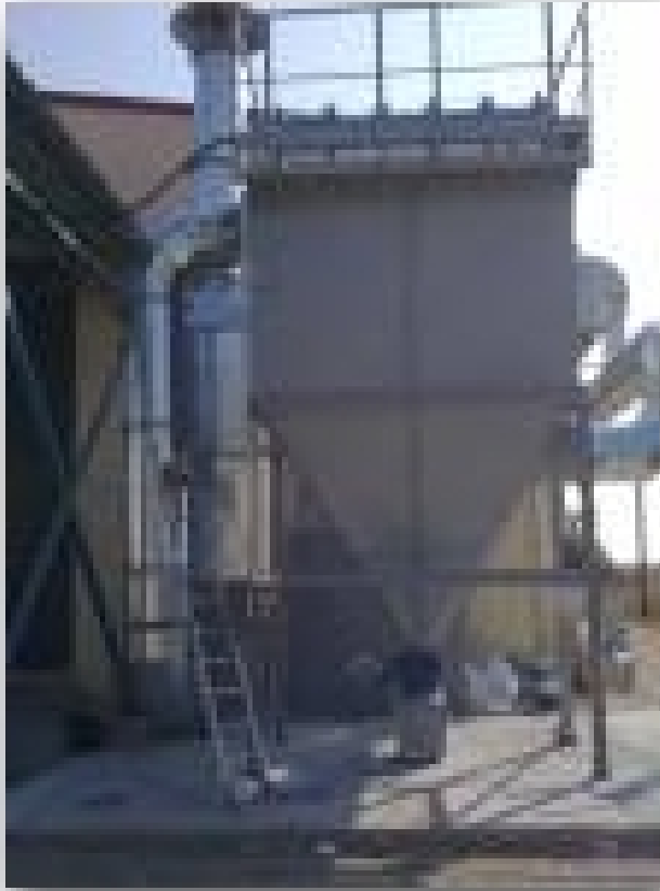
Εγκατάσταση αποκονίωσης μαλύβδου στο τμήμα συγκρότησης μπαταριών
