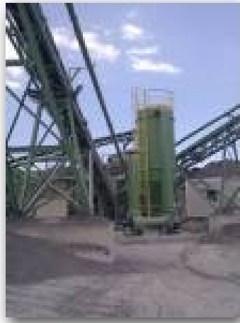
Εγκατάσταση αποκονίωσης λατομείου με σακκόφιλτρο
