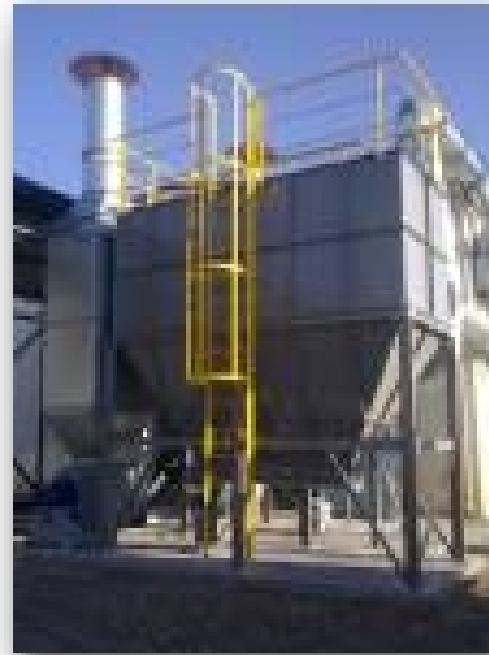
Εγκατάσταση αποκονίωσης σκόνης μολύβδου
