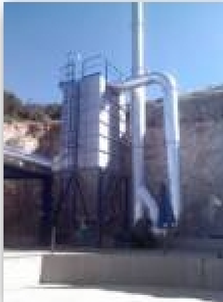
ΕΓΚΑΤΑΣΤΑΣΗ ΑΠΟΚΟΝΙΩΣΗΣ ΛΕΒΗΤΑ ΚΑΥΣΗΣ ΠΥΡΗΝΟΞΥΛΟΥ
