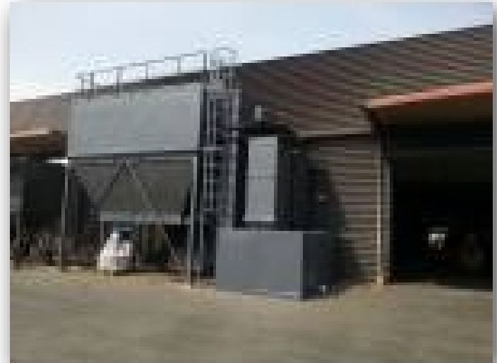
Ζεύγος βιομηχανικών, αυτοκαθαριζόμενων φίλτρων αποκονίωσης μηχανών επιμετάλλωσης
