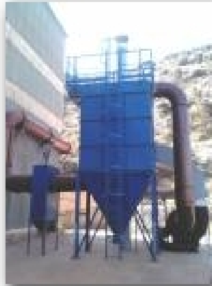
Εγκατάσταση αποκονίωσης χυτηρίου Αλουμινίου στην εταιρεία Αλουμίνιο της Ελλάδος
