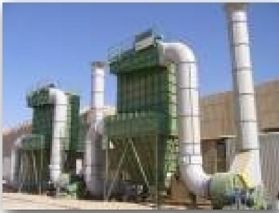
ΦΙΛΤΡΑ ΑΠΟΚΟΝΙΩΣΗΣ ΦΩΣΦΑΤΟΥ AQABA PORT
