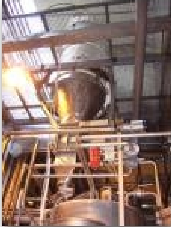
Αποκονίωση εγκατάστασης αερομεταφοράς ζάχαρης σε εργοστάσιο αναψυκτικών
