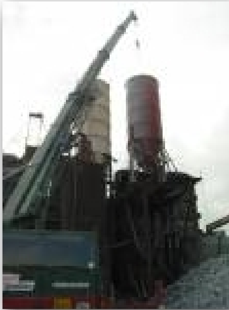
Σιλο για ret-coke, με φίλτρα αποκονίωσης και εξοπλισμό ασφαλείας
