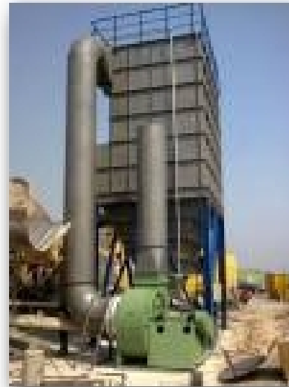
Αποκονίωση ασφαλτικού συγκροτήματος, ικανότητας 80 Tn/h
