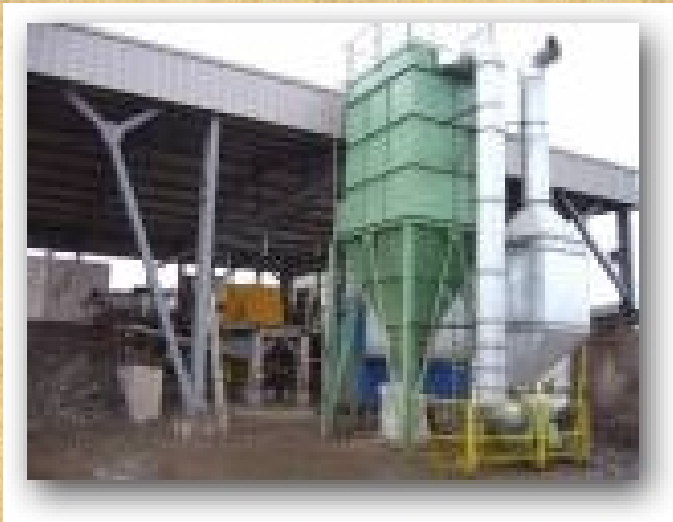
Αποκονίωση εγκατάστασης ανακύκλωσης οχημάτων
