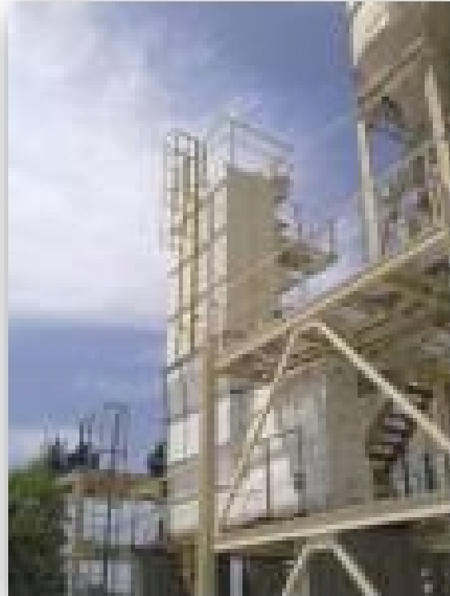
Φίλτρο αποκονίωσης σε επεξεργασία υδράσβεστου
