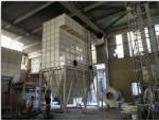
Σακκόφιλτρο επιφάνειας 814 m 2 , για αποκονίωση αδρανών
