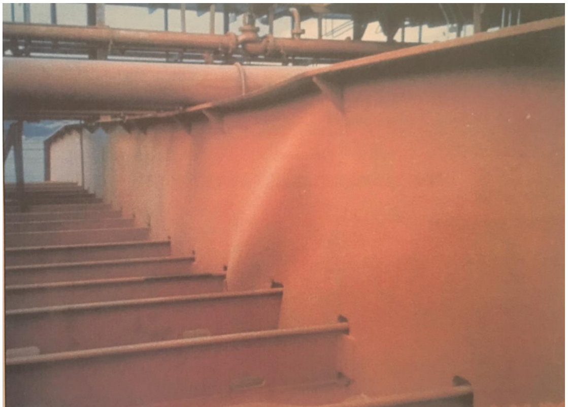
Εικόνα 4: Τοπικός λυγισμός πέλματος σε υποστύλωμα καταστρώματος
