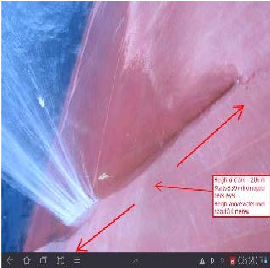
Εικόνα 5: Ρωγμή στα πλευρικά τοιχώματα από την πίεση του νερού στις δεξαμενές έρματος.
