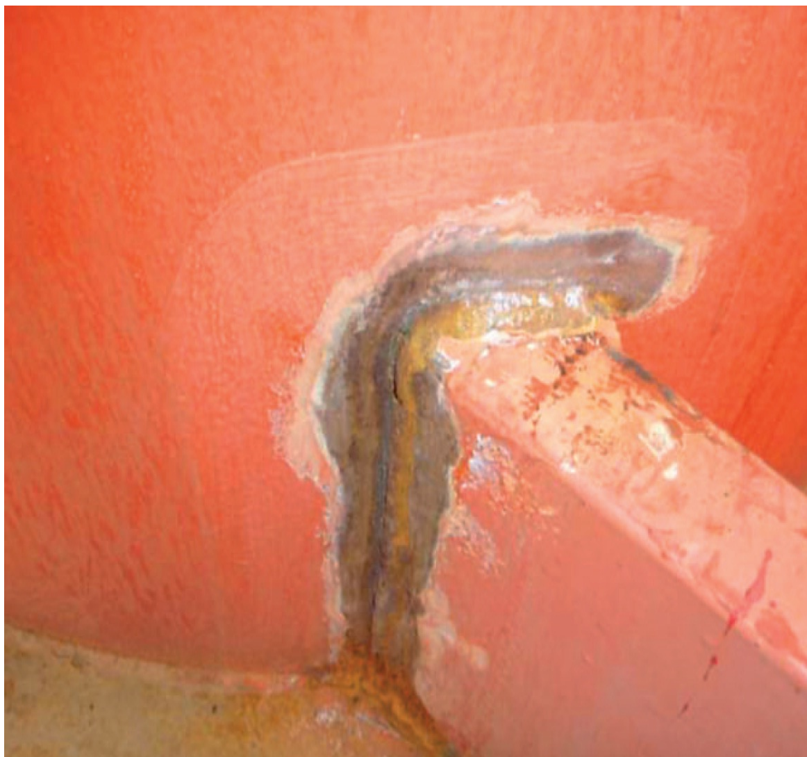
Εικόνα 4: Ρωγμή στην σύνδεση της μεταλλικής κατασκευής του καταστρώματος.
