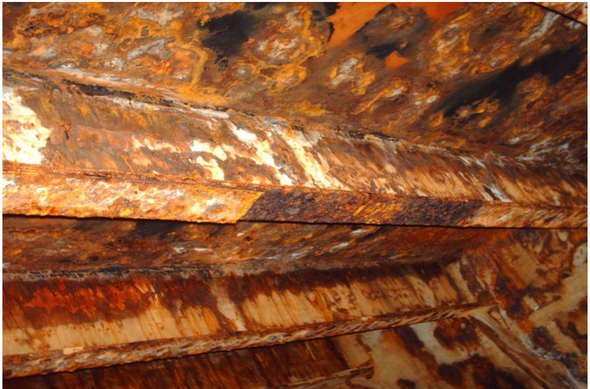
Εικόνα 2: Επίδραση της διάβρωσης στα ενισχυτικά του εσωτερικού άνω πλευρικής δεξαμενής.
