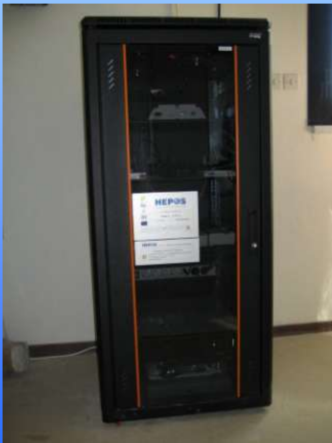
Rack σταθμών αναφοράς
