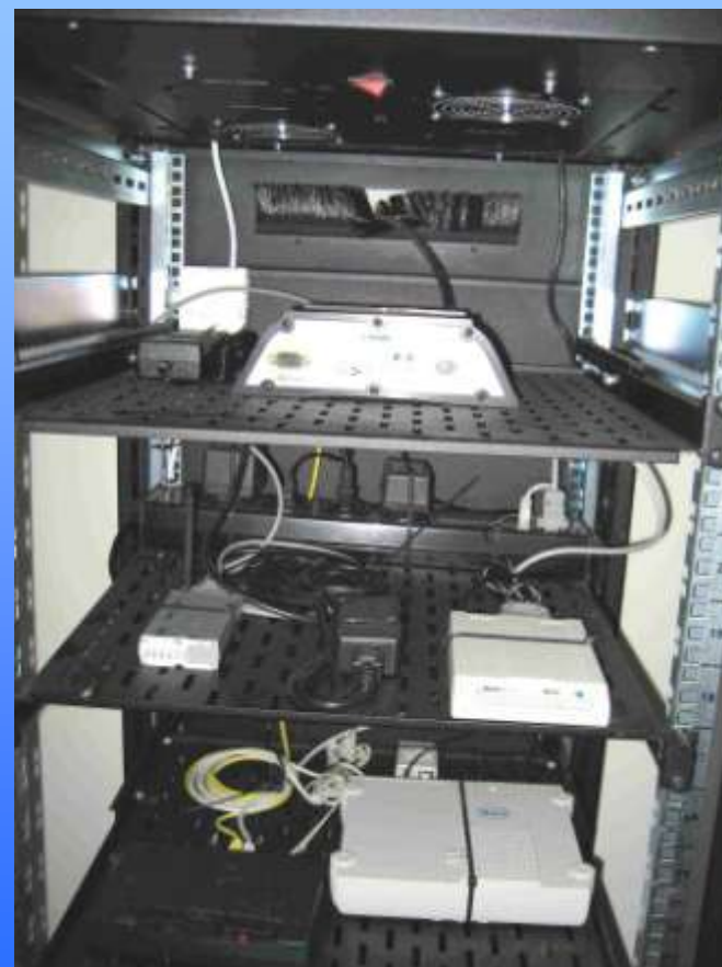
Εξοπλισμός στο rack
