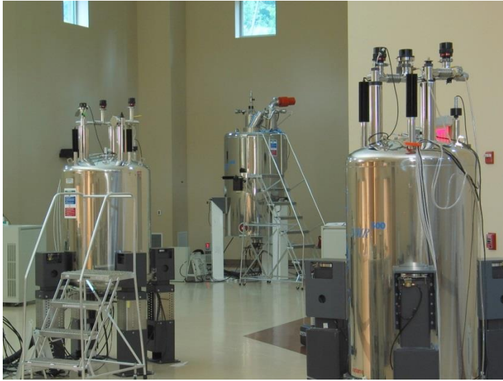
Σχήμα: Εγκατάσταση αναλυτή NMR
